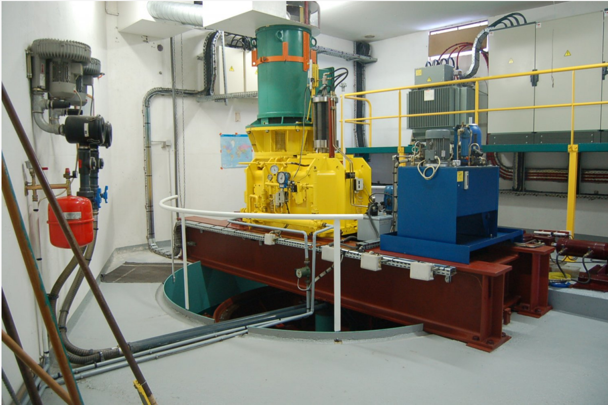
La microcentrale hydraulique de Chamalières-sur-Loire fournit de l'électricité à 400 foyers.
