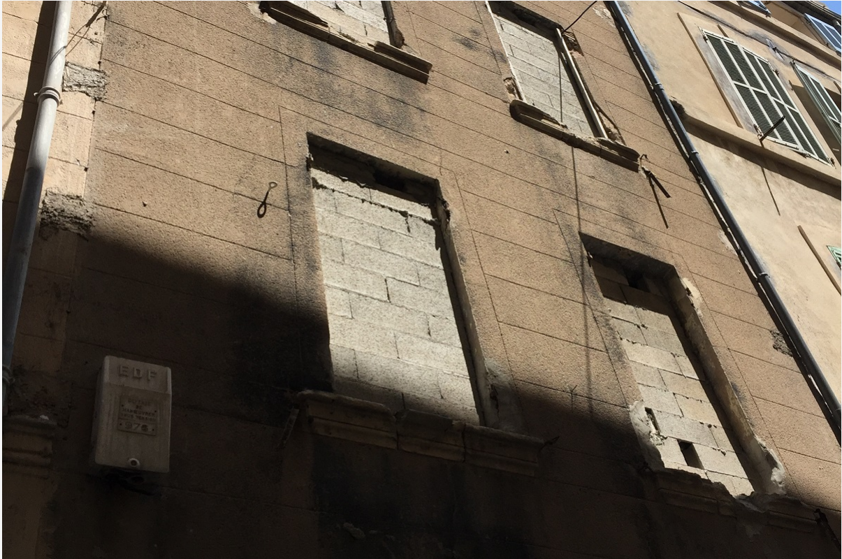
Un immeuble en péril dans le quartier du Panier.
