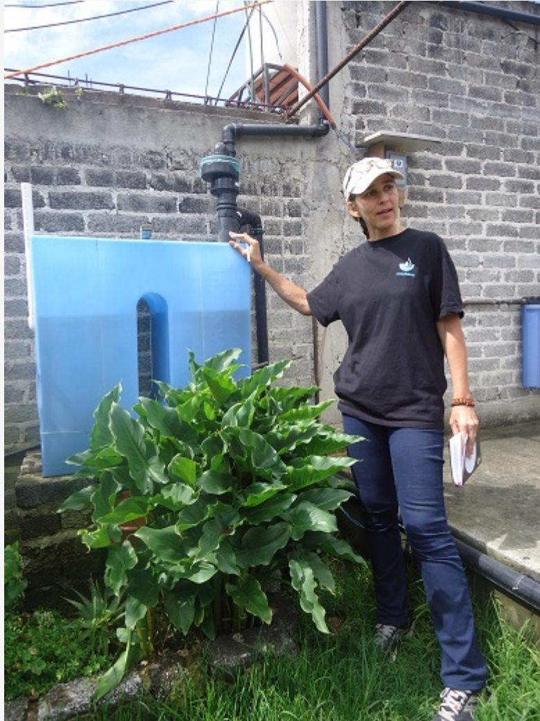
De telles installations, ici réalisée par l'organisation Isla Urbana, permettent de récupérer jusqu'à 50 000 litres par an.
